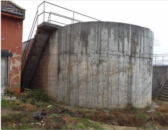
Çerkezmüsellim Atıksu Arıtma Tesisi
