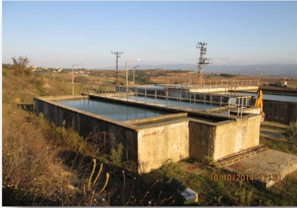
Sağlamtaş İçme Suyu Arıtma Tesisi Havuzları
