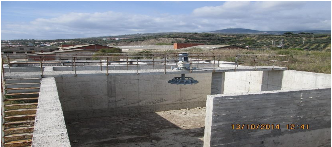
Mürefte Atıksu Arıtma Tesisi
