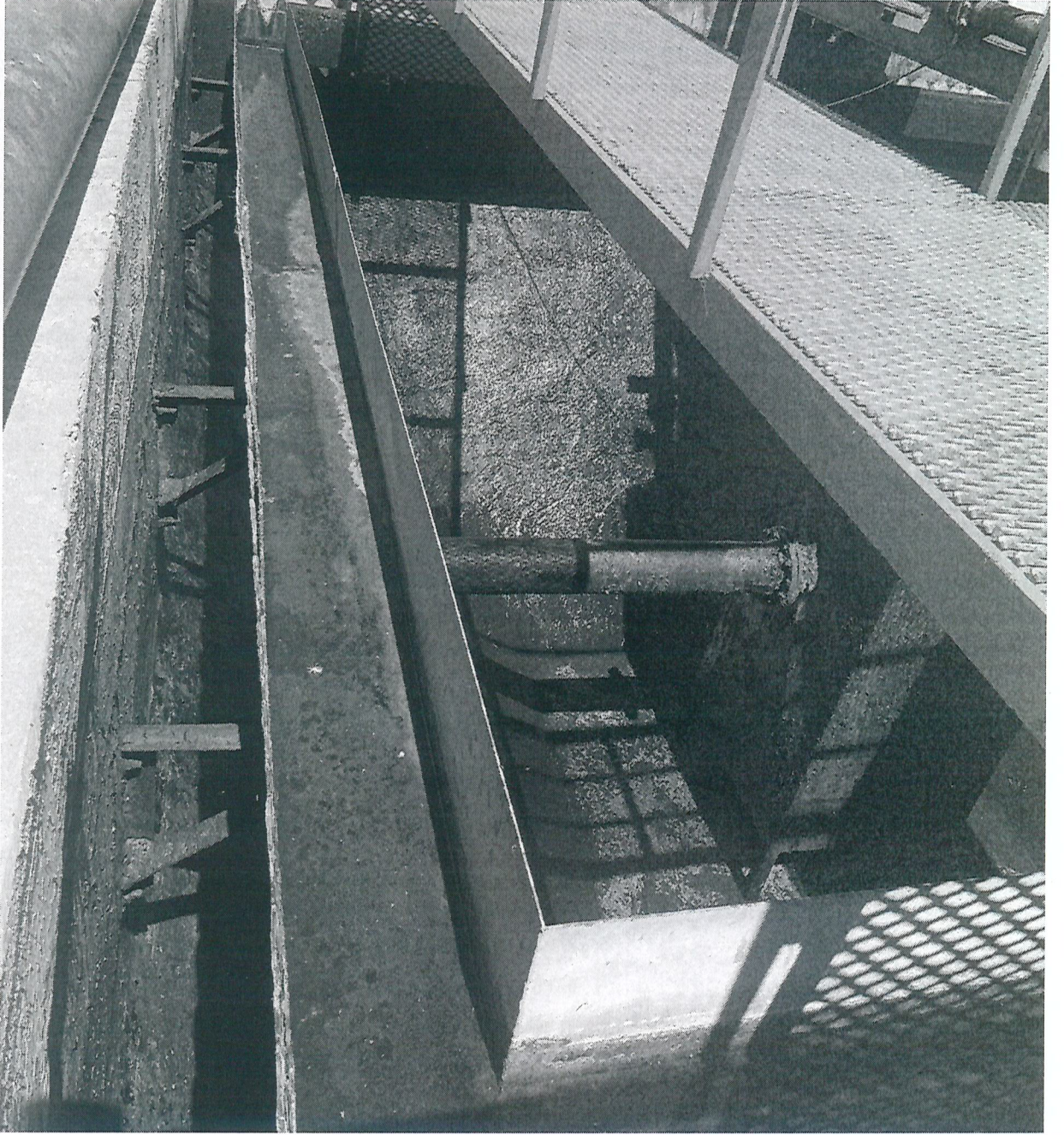
Görsel 3: Çöktürme Havuzu, ayarlaması yapılacak taşıyıcı konsollar ve savaklar.
