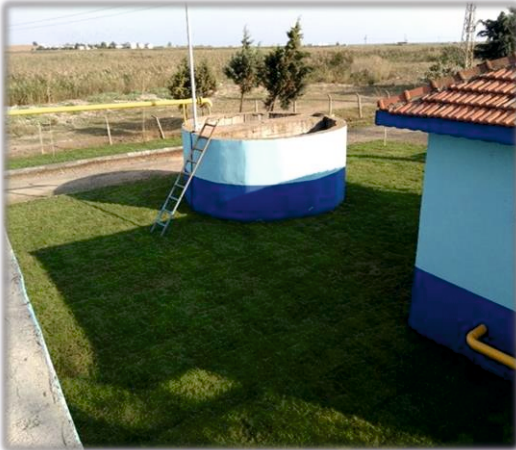
Çamur Yoğunlaştırma Havuzu
