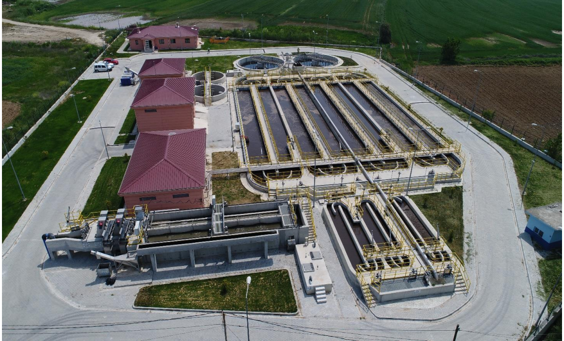
Tesisin Genel Görünümü
