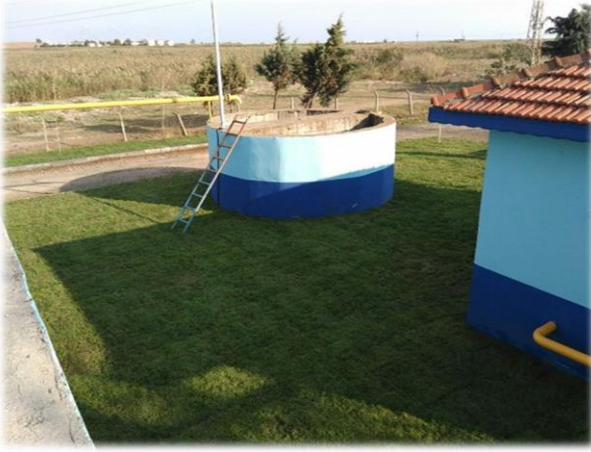
Çamur Yoğunlaştırma Havuzu
