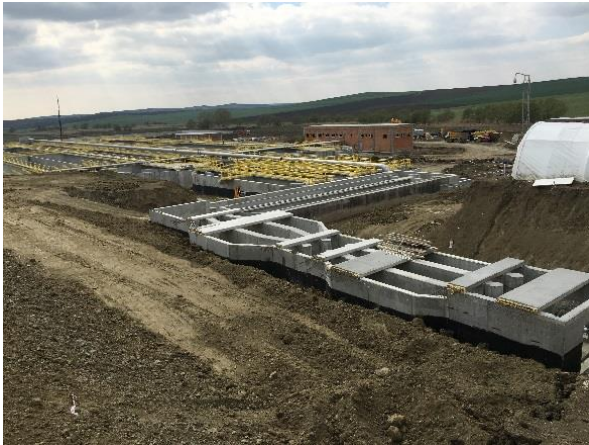
Çorlu Atıksu Arıtma Tesisi
