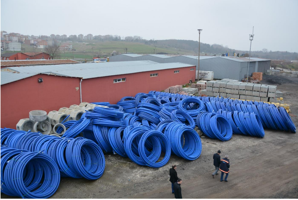
Alımı Yapılan İçme Suyu Borularının Cinslerine Göre Dağılımı
