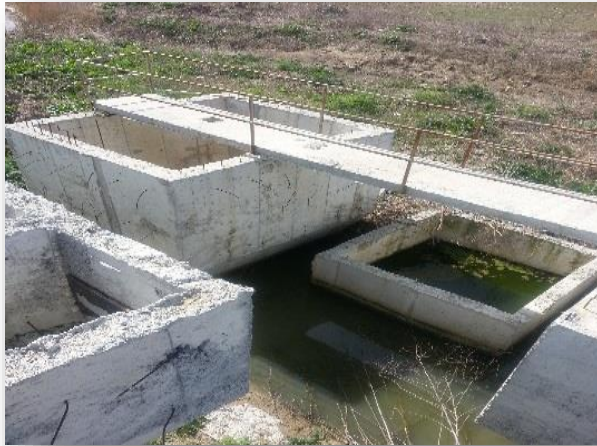
Çerkezmüsellim Atıksu Arıtma Tesisi
