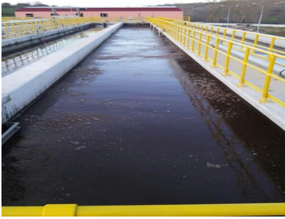
Malkara Atıksu Arıtma Tesisi
