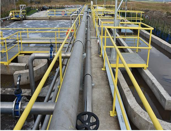
BİO-P ve Havalandırma Havuzu
